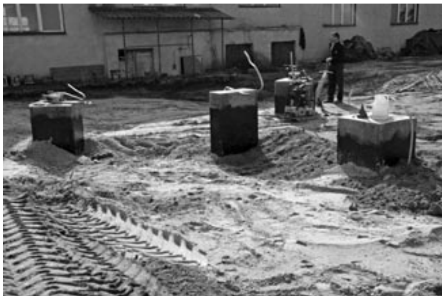
Budowę rozpoczęto przed uprawomocnieniem się pozwolenia.
